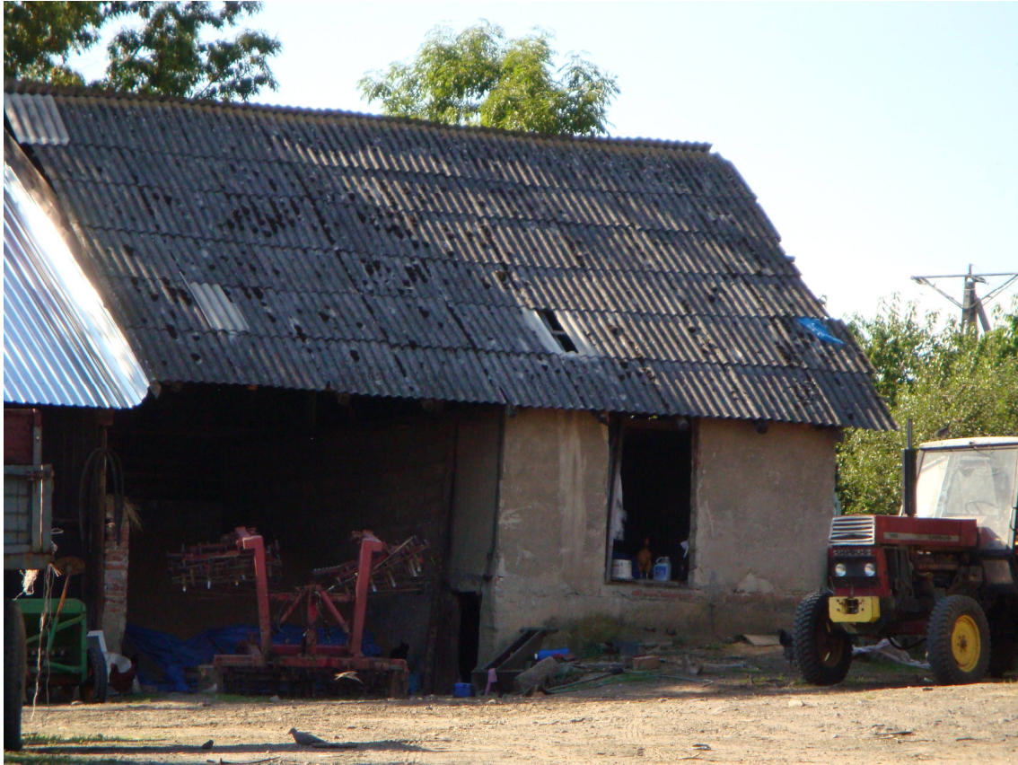
Fot. 2 Budynek gospodarczy z wyraźnie uszkodzonymi płytami azbestowymi, w miejscowości Targowica
