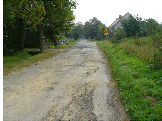
Fot. 27. Droga w Brochocinie zniszczona sływem powierzchniowym
