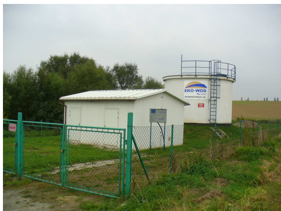
Fot. 51. Stacja uzdatniania wody w Piotrowicach Polskich
